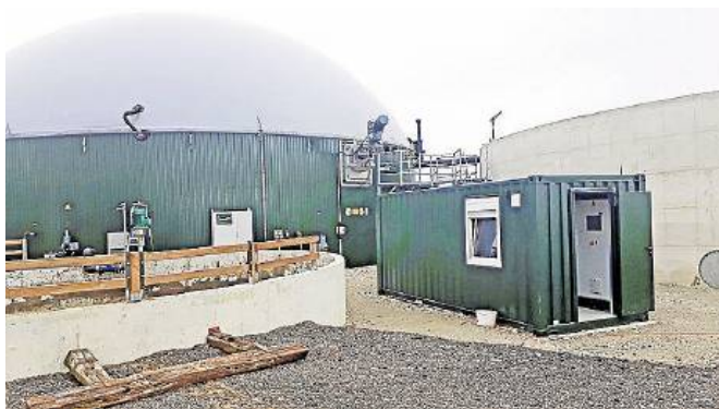
Eine Biogasanlage von Plan-ET aus Vreden und ein Technikcontainer von Schunk Mobilraum aus Stadtlonn. FOTO PRIVAT
